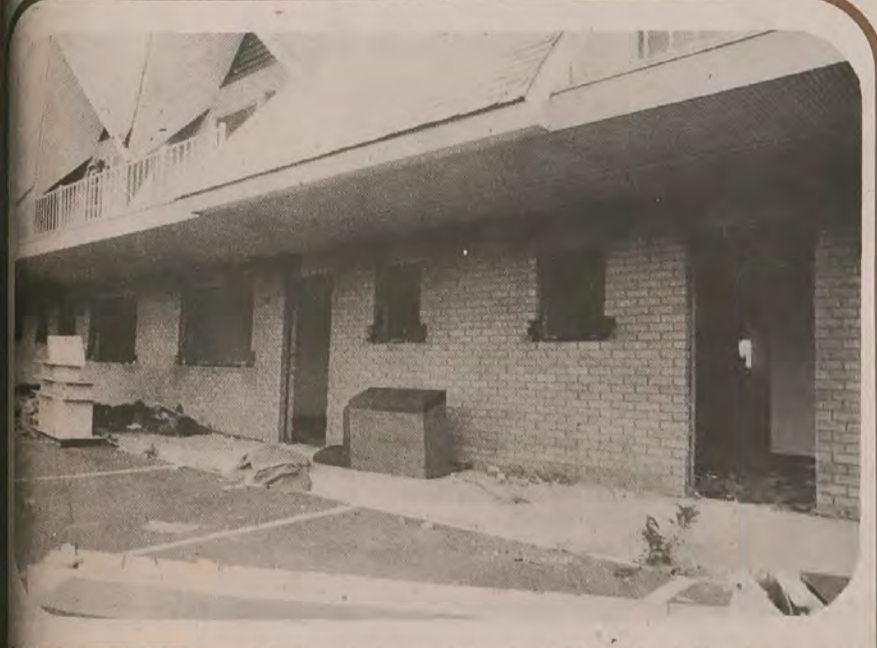
L'aile du motel Albatros qui était restée intacte à la suite de l'incendie de l'an dernier, sera éventuellement déplacée à l'arrière du site, à l'endroit où on se propose de reconstruire le motel.
